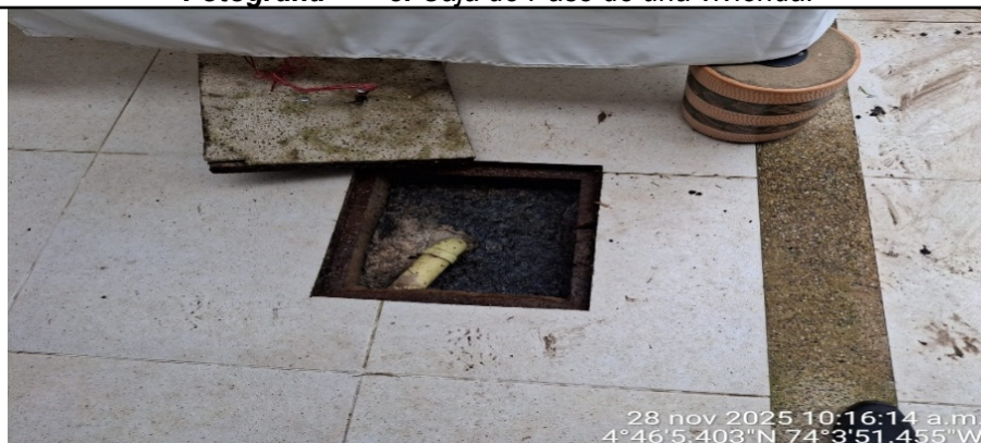
Fotografía No. 4. Trampa de Grasas y Aceites de una vivienda
