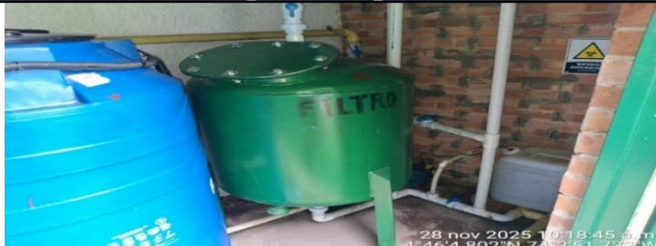
Fotografía No. 9. Filtro de Grava, arena y carbón activado.
