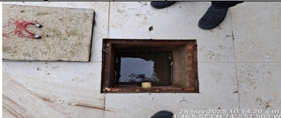
Fotografía No. 5. Caja de paso general de una vivienda.
