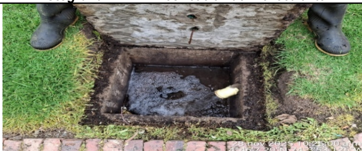
Fotografía No. 11. Caja de inspección externa.
