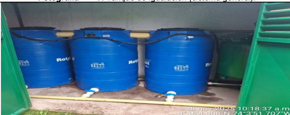
Fotografía No. 8. Tanques anaerobios con Floculación y decantación.
